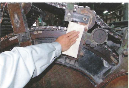
機械周りの漏油の拭き取り SB-30
