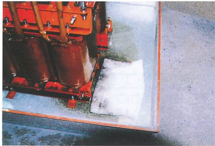
変圧器メンテ時の油吸着 NKシート, Kシート
