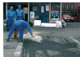
舗装面へこぼれた油の処理
